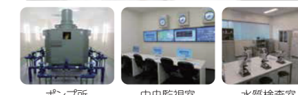
ポンプ所 中央監視室 水質検査室
