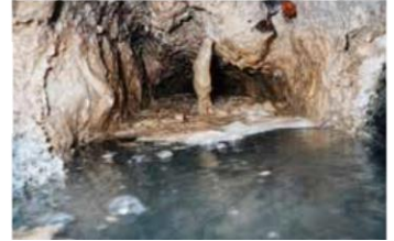
▲キッチンから流れた油で詰まった下水道管
